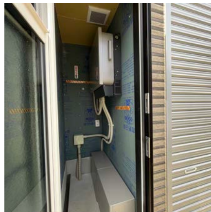
Elect storage 蓄電ヤード
